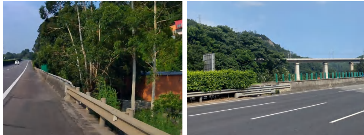
图3-5 混凝土护栏与钢护栏搭接现状
