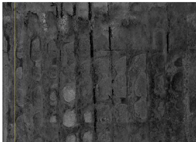
图 3-3 坪岗 1 号隧道上行 AK3114+679 右拱顶 6.15 米~6.74 米 钢筋外露 S=8.44 \text{ m}^2
