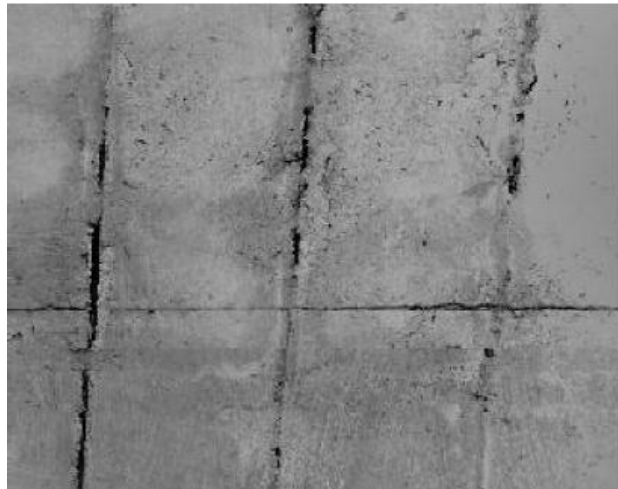
图 3-1 山峰 2 号隧道下行 BK3092+851 右拱顶 5.28 米~5.83 米钢筋外露 S=3.90 \text{ m}^2
